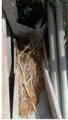
Fotografía 10. Desechos orgánicos sobre elementos inferiores del puente. Fuente: Elaboración propia
