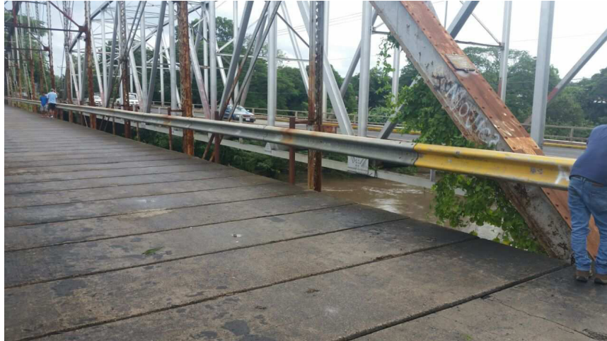
Figura 4-4. Puente en Guardia, Paso de Huracán Otto
