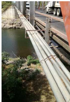
Fotografía 8. Tuberías de servicios públicos que utilizan el puente como soporte. Fuente: Elaboración propia
