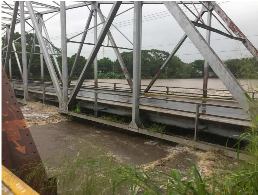
Figura 13. Crecida en el cauce y paso inhabilitado en el puente
