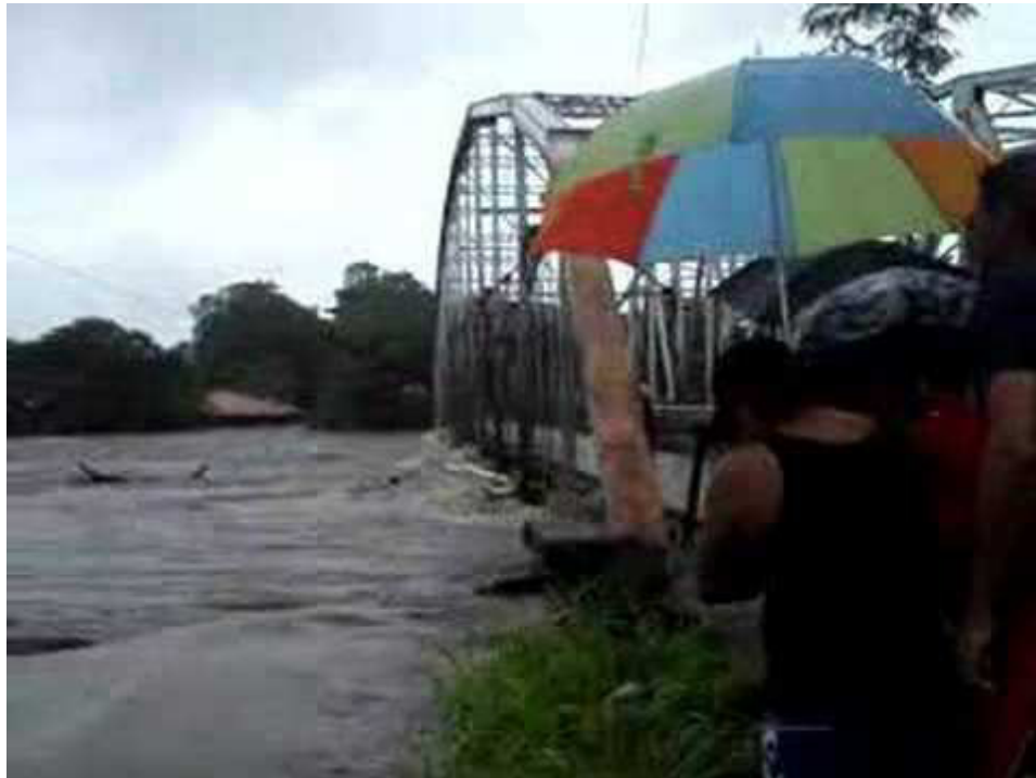
Figura 4-1. Puente en Guardia 13 de Octubre del 2007 Mediante un video captado el 13 de octubre del 2007 en el sitio del puente en Guardiade Liberia, se evidencia como el agua toca la estructura, al punto de casi sobrepasar la losa de rodamiento del puente viejo. (PUPUPU12345, 2018)
