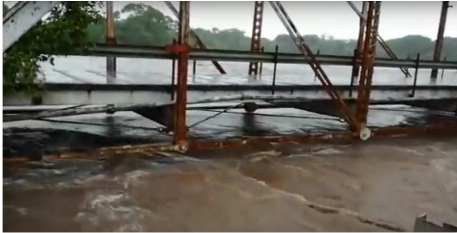
Figura 4-9. Nivel del río aún no baja
